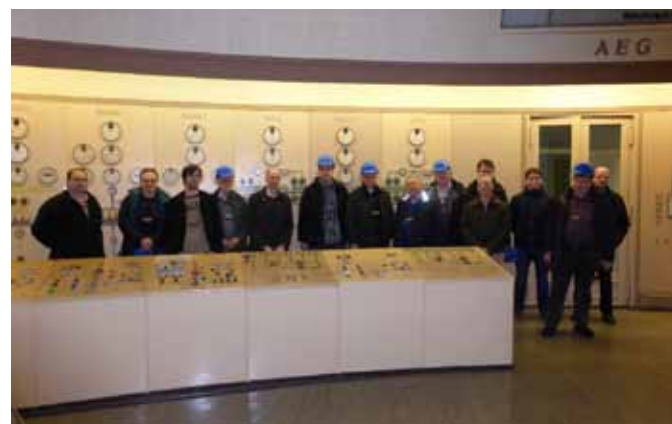
Einblick in die alte Leitwarte des Kraftwerkes.
