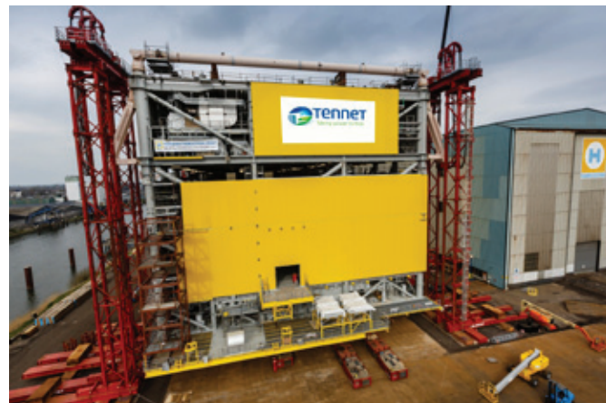
Seeseitige Konverterstation, noch in der Wert
