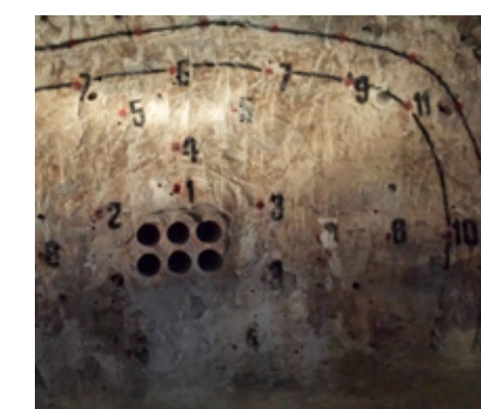
Grubenende mit Sprenglöchern – Die Zahlen legen die Zündreihenfolge fest, so dass die Sprengungen immer von innen nach außen erfolgen.
