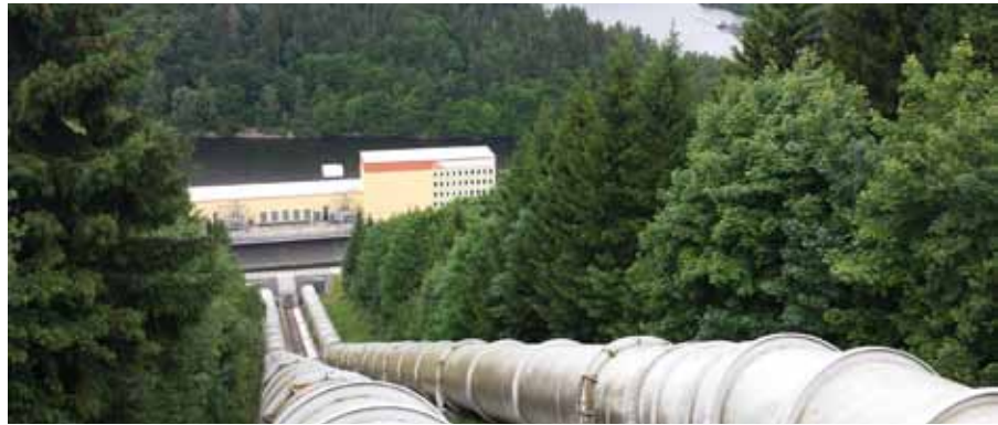
Blick entlang der Druckstollen auf das Turbinenhaus
